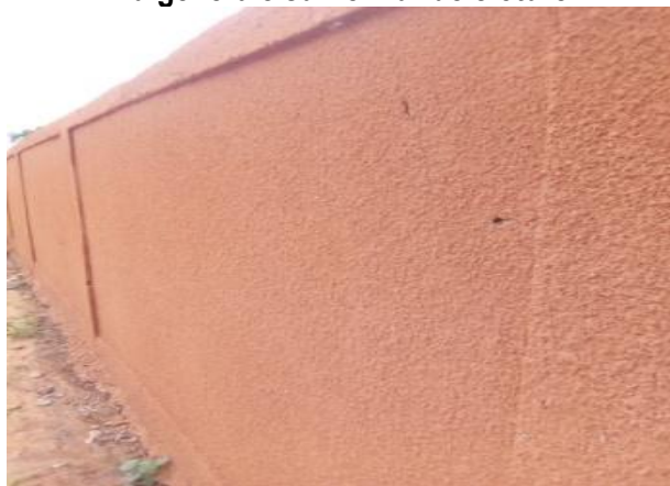
Les fissures constatées sur le mur
