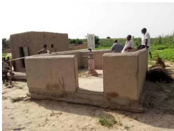
Vue sur le forage non réhabilité – Site de Damagaram Takaya
