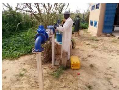
Vue sur le Forage équipé
