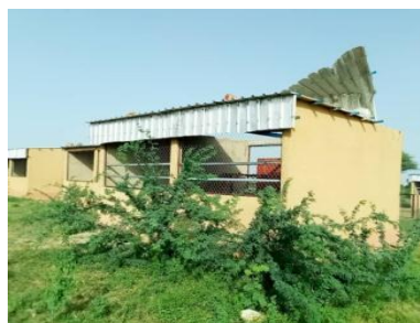
Toiture détachée d'un bâtiment
