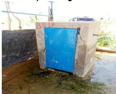
Vue des problèmes des fissures sur le BF (Tirmini)
