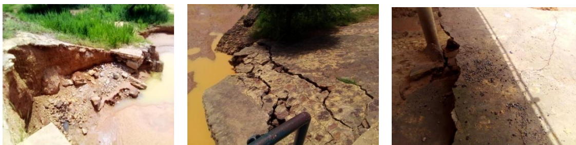
Vue sur les dégradations des ouvrages réalisées (chape et les perrés maçonnés)
