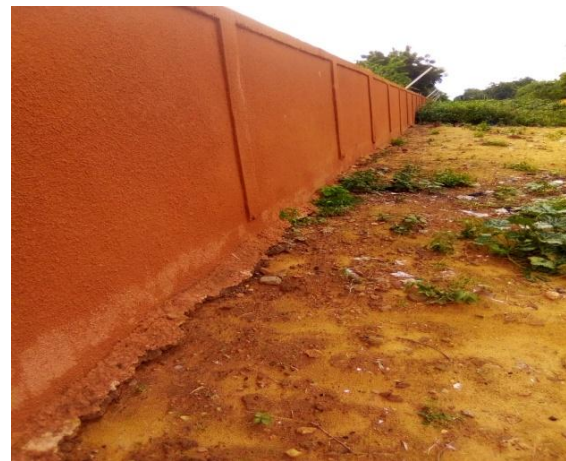
Problème des remblais sur le mur de clôture
