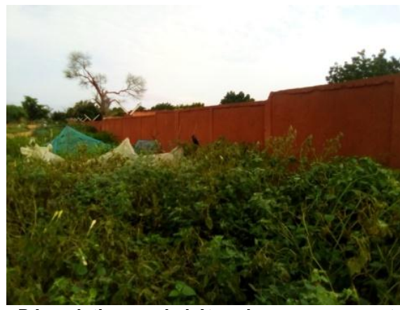
Dégradation sur le béton de couronnement
