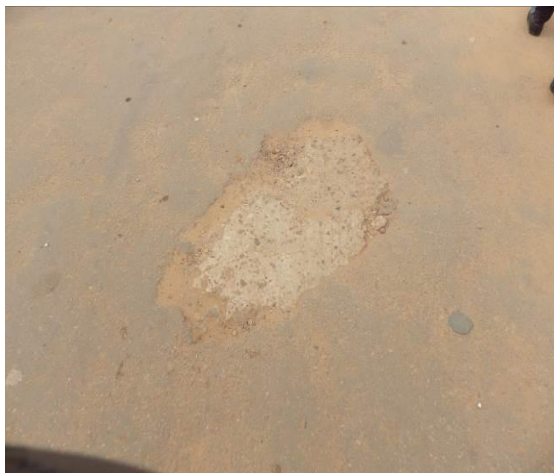
Dégradation sur chaussée HNN
