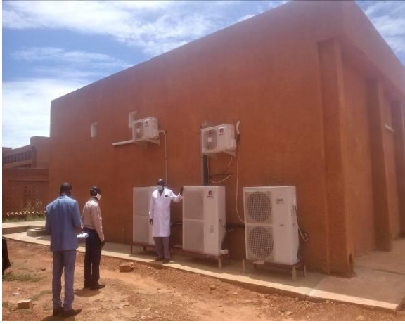
Local d'IRM – Climatisation centrale
