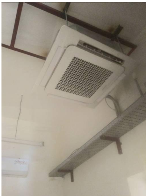
Climatisation Salle Machine
