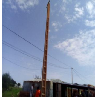
Partie non câblée
