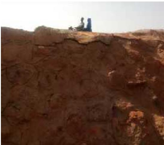
Degardation du perré maonné
