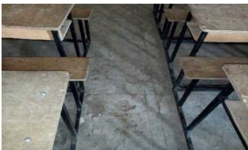
Dégradation du dallage intérieur
