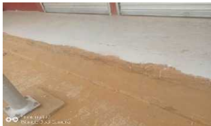
Vue du Degradation du dallage
