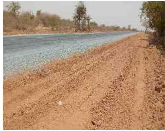
Laterites au niveau des berges de la chaussée
