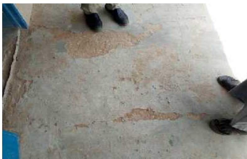
Dégradation de la terrasse.
