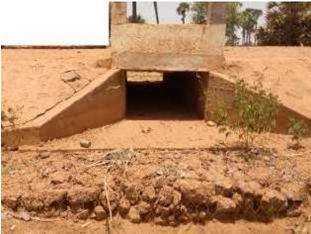
RAVINEMENT DES GABION
