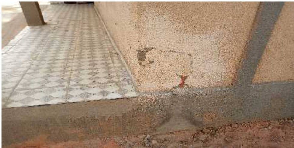
Apparition des fissures
