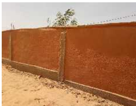
Apparitions des fissures
