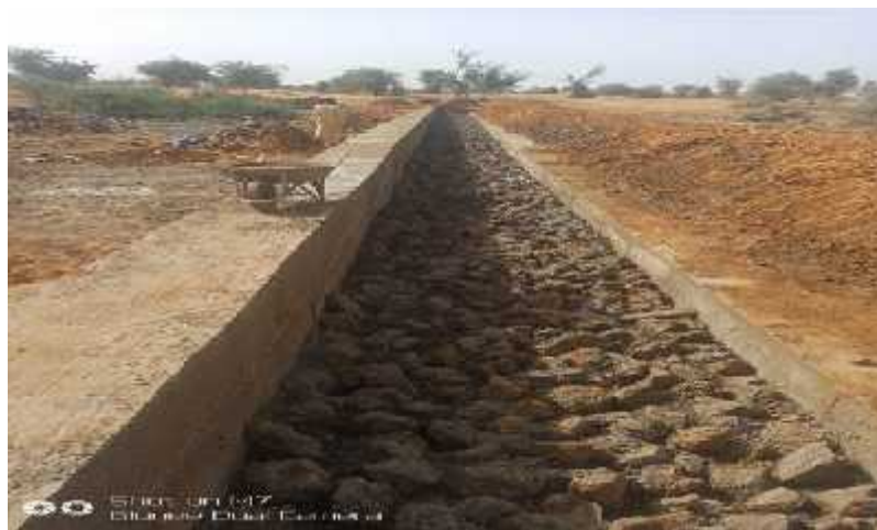
Vue intérieure du seuil d'épandage
