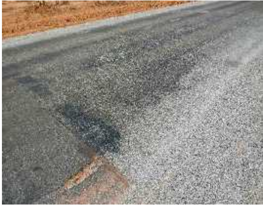
Apparitions des fissures sur la chaussée
