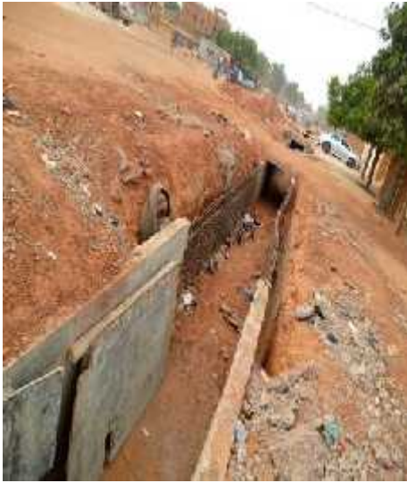
Vue du collecteur (armatures tordues)
