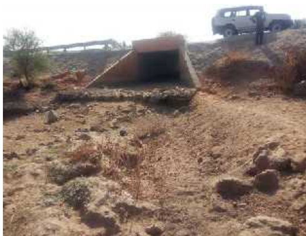
Debut de ravinement des gabions par les eaux des pluies
