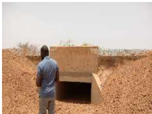
Laterites sur les perrés maçonnés non dégagés
